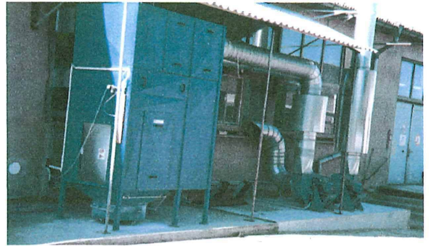
Anlage zur Wärmerückgewinnung
