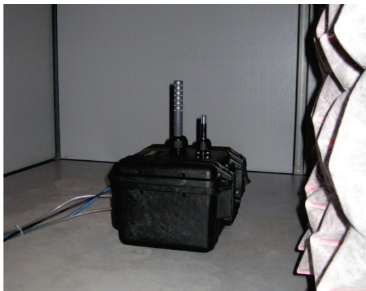
Bild 1: Prototyp der Datenerfassung in einer Klimaanlage
