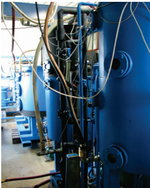
Bild 1: Ansicht der im ILK-Versuchsfeld installierten Resorptionskälteanlage
