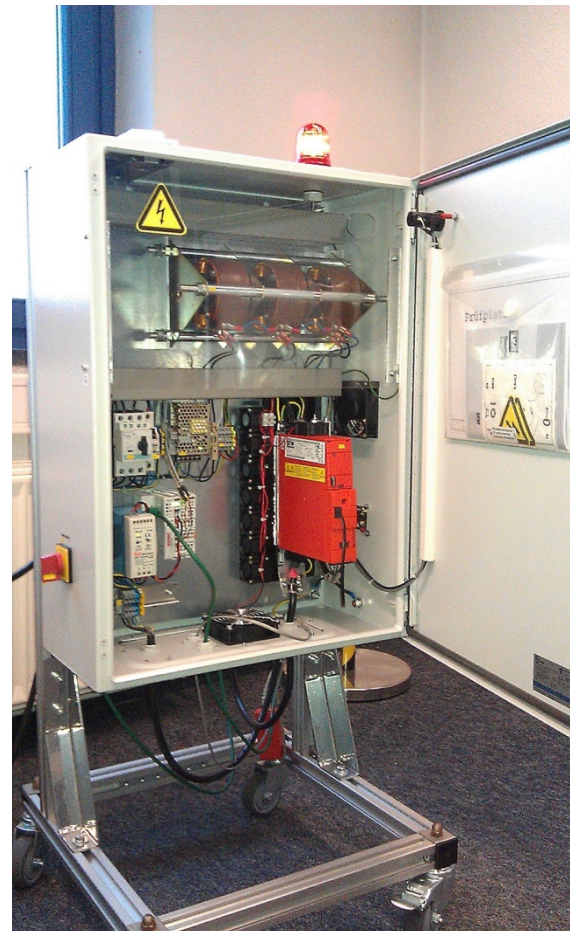
Bild 2: Schaltschrank für die Qualitätsprüfung teilentladungsfreier elektrischer Isoliersysteme
