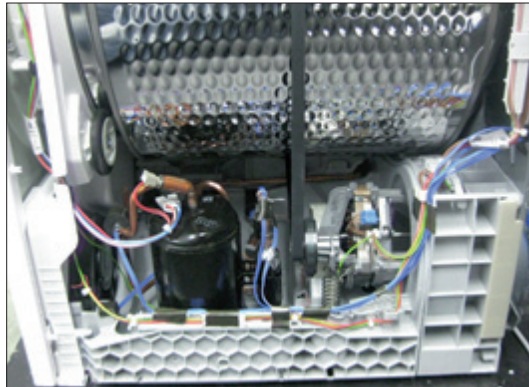
Abbildung 1: Temperatur-Anlagefühler und Drucksensoren am WP-WT
