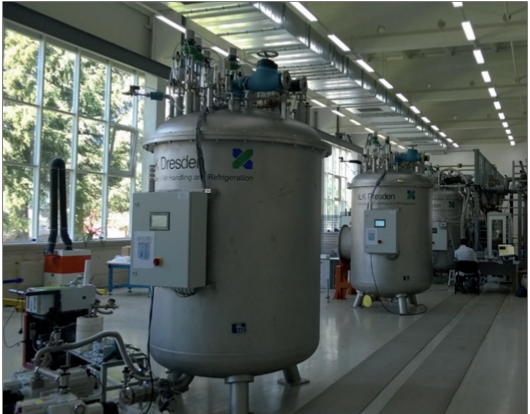
Abbildung 1: Helium Teil-Verflüssiger des ILK Dresden in der Versuchshalle am JINR
