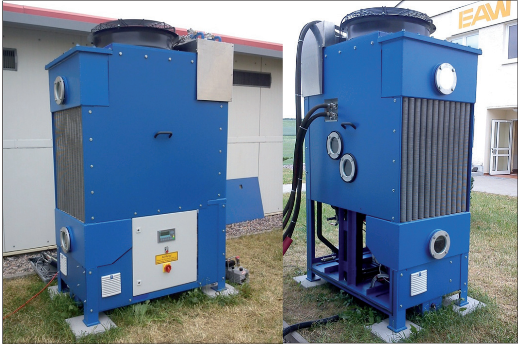
Abbildung 2: Funktionsmuster der direkt luftgekühlten Wasser/LiBr-Absorptionskältemaschine während der Felderprobung
