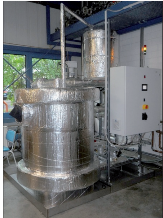
Abbildung 1: Latentwärmespeicheranlage auf der Basis von PE-UHMW als ungekapseltem, formstabilem PCM im Technikum des ILK Dresden
