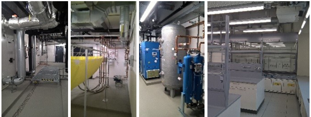
Abbildung 3: Technikzentralen und Labor
