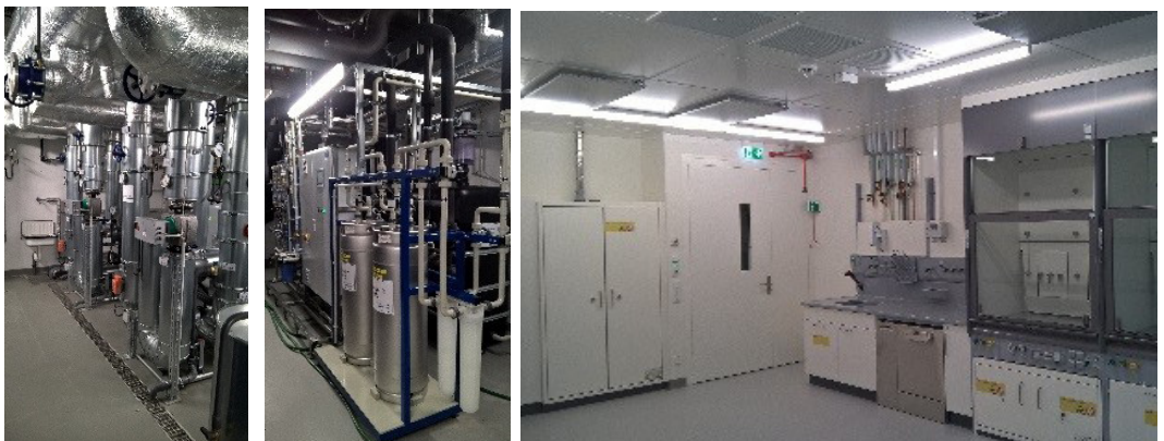
Abbildung 4: weitere Technikzentralen und Labor
