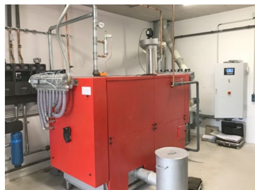
Bild 2: Biomasseheizkessel der Fa. A.P. Bioenergietechnik
