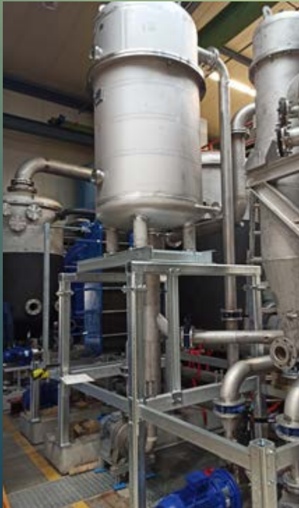
Bild 1: Versuchsanlage im Aufbau (ILK Dresden)
